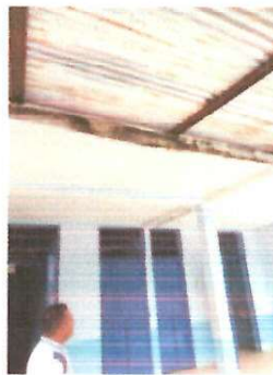
FOTO No.2: ESTRUCTURA DE TECHO. Sustrución de estructura de techo en mal estado
