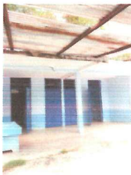
FOTO No.1: CUBIERTA DE LÁMINA. Sustrución de lámina acanalada por lámina troquelada en mal estado.
